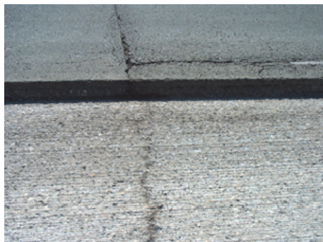
Slika 3. Poprečna i uzdužna pukotina [4]
